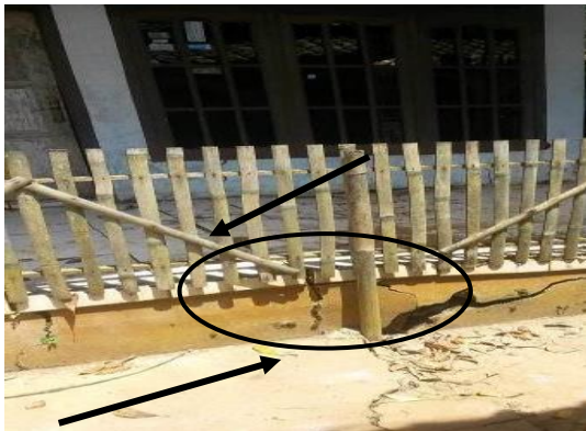
Gambar 1. Rekahan yang tampak jelas pada teras rumah penduduk di Blok Gunung Payung, Desa Banyusari, Kecamatan Malausma, Kabupaten
