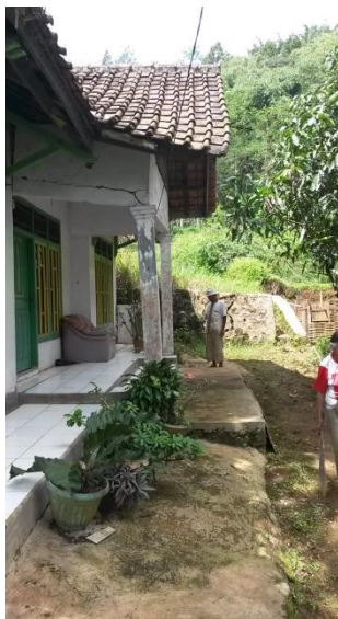
Gambar 4. Pergerakan tanah yang menyebabkan retakan dan pergeseran pada bagian tiang teras rumah penduduk.
