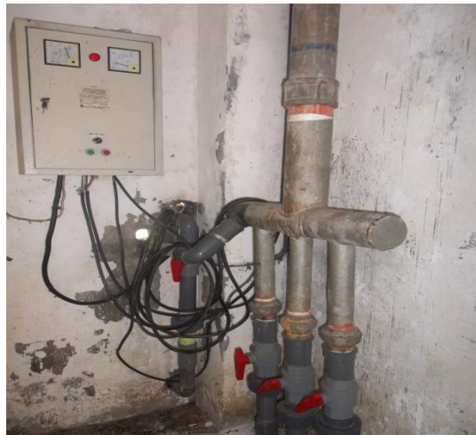
Gambar 6. Pipa Distribusi Sebelum IbM (3 Jalur)
