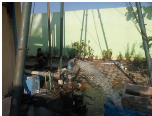
Gambar 14. Kondisi Sumur Air Bersih di Sono Tengah setelah IbM
