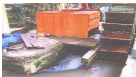
Gambar 2. Kondisi awal PLTMh Sebelum di lengkapi peralatan pintu pengelak air dari Irigasi.
