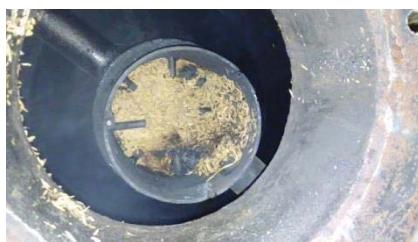
Gambar 4. Bahan baku yang tidak turun ke ruang pembakaran
