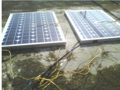
Gambar 3. Instalasi pengujian Modul surya.
