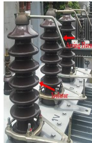
Gambar 6. Arcing Horn di Bushing Trafo
