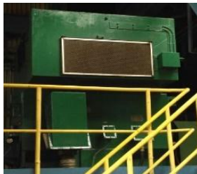
Gambar 4.1 Motor GRF yang terpasang di area groundfloor Boiler
