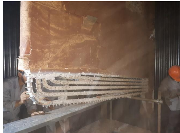
Gambar 4.2. Lokasi kebocoran tube platen superheater
