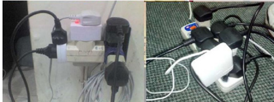
Gambar 7 : Overload pada sistem instalasi listrik
