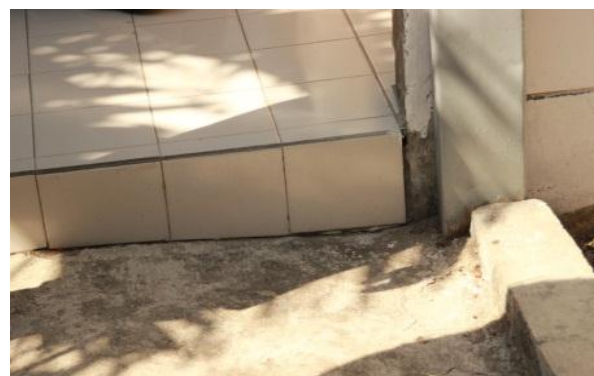
Gambar 11. Tangga di ujung selasar yang membahayakan
