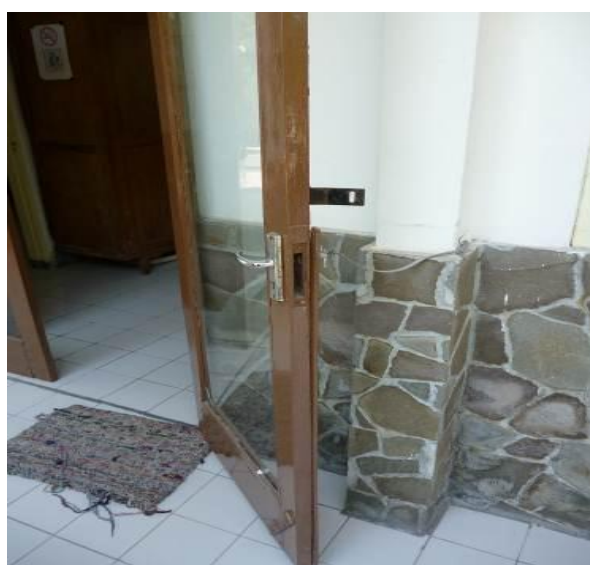
Gambar 8. Pintu yang membahayakan karena membuka ke luar selasar, yang menyebabkan kecelakaan pada Siswa Tunanetra. Dan ujung kolom yang tajam yang dapat membahayakan Siswa.
