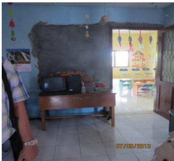
Gambar 2. Kondisi Eksisting Kelas
