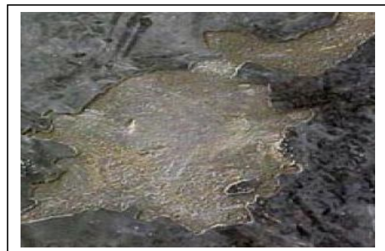
Gambar 1. Delaminasi selimut beton
