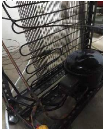
Gambar 12 Uap air pada pipa suction kompresor 3) Pengujian kinerja mesin show case pendingin sosis tanpa menggunakan produk
