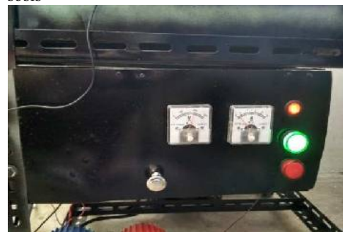
Gambar 5 Instalasi kabel pada mesin show case pendingin sosis
