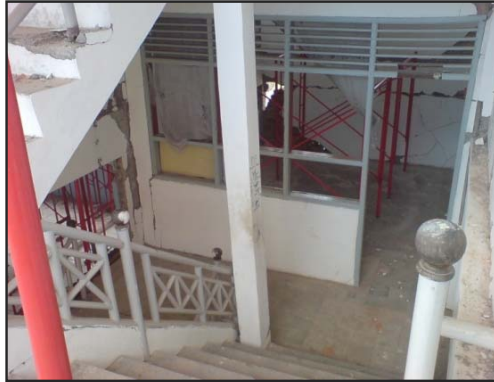
Gambar 9. Kerusakan pada Pelat Lantai
