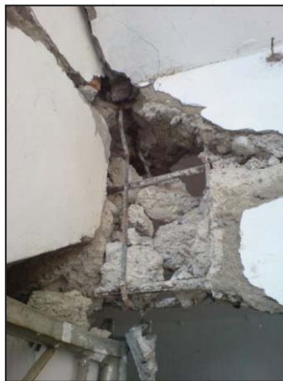
Gambar 8. Kerusakan pada Balok
