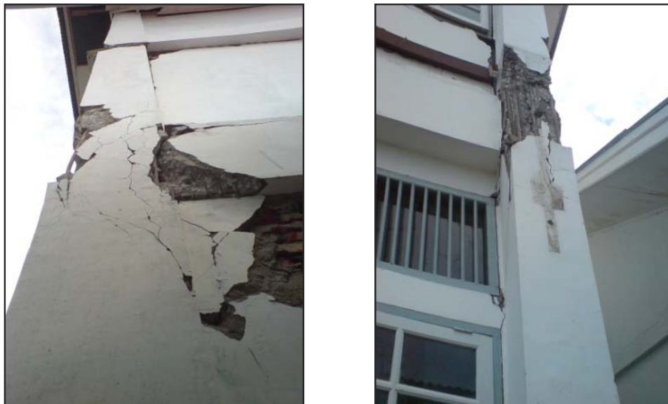
Gambar 6. Kerusakan pada Kolom
