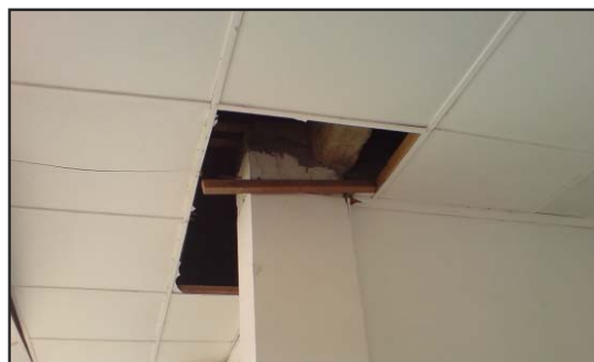
Gambar 4. Kerusakan Non Struktural pada Plafon
