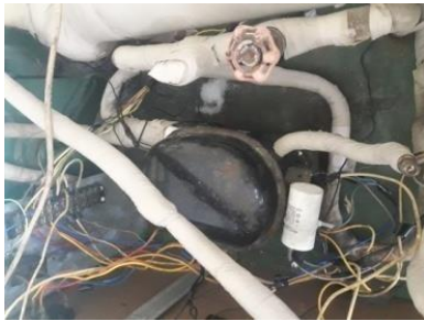
Gambar 1. Kompresor R134a pada rangkaian mesin pendingin
