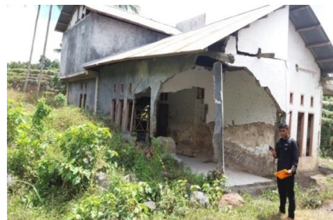
Gambar.3 bangunan rumah rusak berat.
