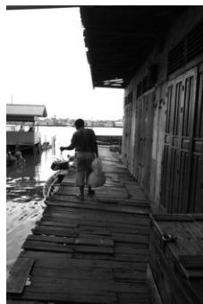
Gambar 3. Konstruksi hampir roboh dan rusak Sumber: Survey, 2015
