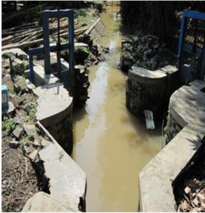
Gambar 3 Saluran Irigasi Daerah Binongyang Bersumber dari Saluran Tarum Timur Jawa Barat (Survey Lapangan, 2011)
