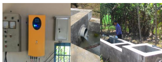
Gambar 3 Alat Konversi Energi Matahari ke Listrik (Inverter) dan Alat Ukur Debit
