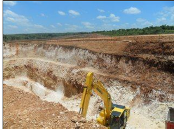
Gambar 5. Kondisi batugamping berongga Blok Sawir
