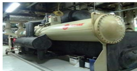
Gambar 4. Foto sistem AC water cooled chiller yang diinvestigasi
