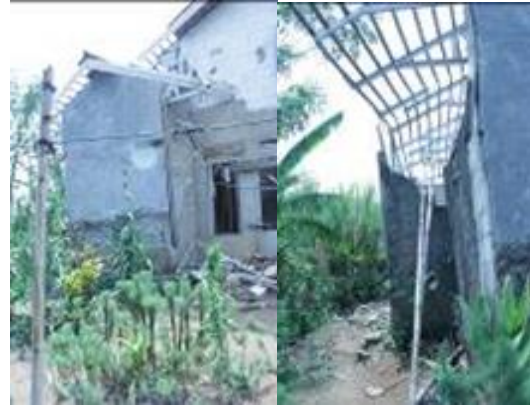
Gambar 7. Rumah Amblas di Dusun Cipondoh
