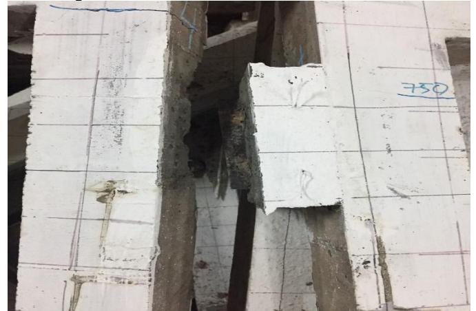
Gambar 15. Kondisi terakhir retakan pada kuda-kuda Tipe B
