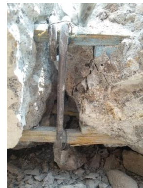
Gambar 15 Tulangan bambu setelah pengujian balok
