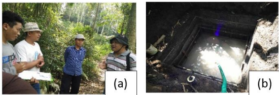
Gambar 5. (a) diskusi lapangan penentuan lokasi pompa dan trase pipa. (b) penggalian pondasi pompa .
