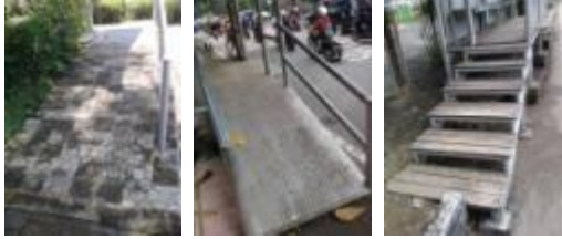
Gambar 10. Ramp tanpa guiding block Sumber: Dokumentasi Penulis (2015)
