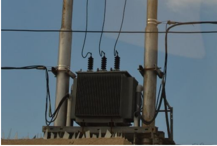
Gambar 3. Transformator Distribusi Rufe Pantai 100 kVA
