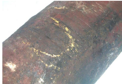
Gambar 1 : Tube furnace yang mengalami retakan. Terlihat terdapat beberapa retakan. Retakan berada pada arah jam 12.
