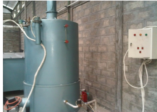
Gambar 2. Boiler pembangkit uap
