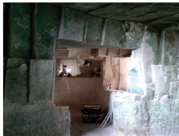
Gambar 3. Keretakan batuan atap
