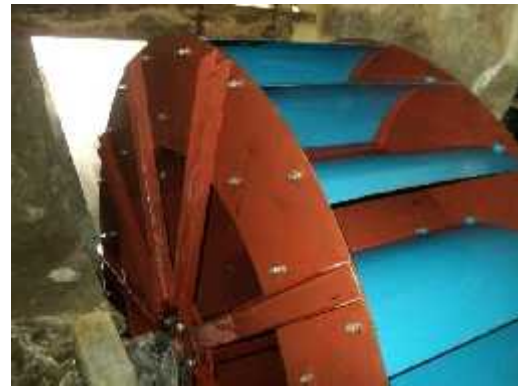
Gambar 15. Kontruksi roda kincir KASKD yang telah dirakit dan telah terpasang di dalam rumah pembangkit dan siap dioperasikan, tampak banyak baut-mur yang digunakan untuk sistem penyambungan.
