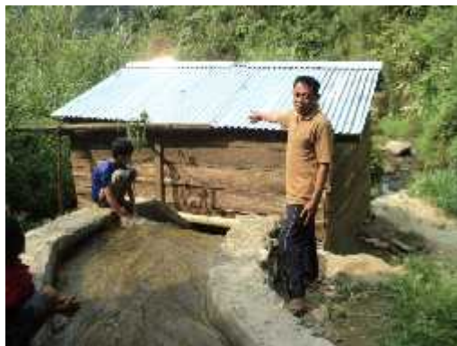
Gambar 18. Bangunan rumah pembangkit KASKD, tampak air mengalir melalui saluran lurus dan masuk ke dalam rumah pembangkit yang di dalamnya terpasang roda kincir, sistem transmisi, generator dan panel instalasi listrik.
