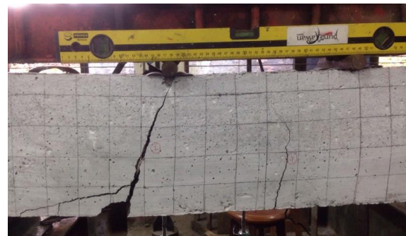
Gambar 8. Pola retak balok beton bertulangan bambu tanpa kait
