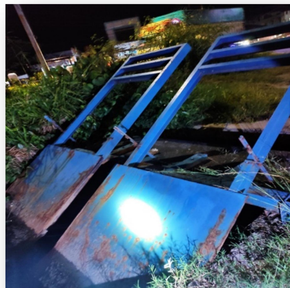
Gambar 4. Kondisi Pintu Air Jl. Sultan Hasanuddin
