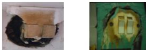
Gambar 7. Saklar Tidak Standar
