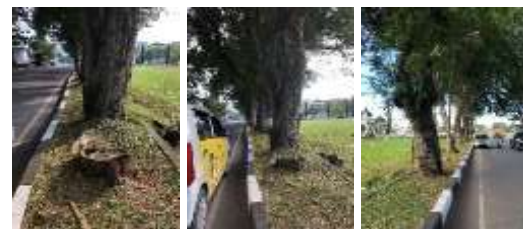
Gambar 11 Kondisi Jalur Pejalan Kaki di Hotel Aceh (Sumber: Penulis, 2022)
