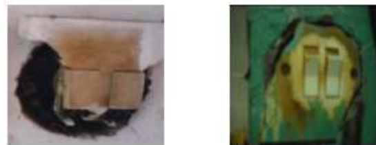
Gambar 7. Saklar Tidak Standar
