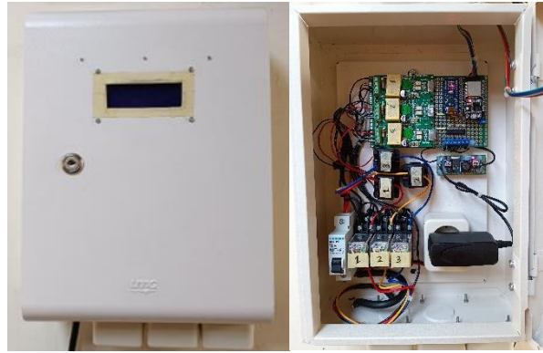
Gambar 3. Komponen Sistem Monitoring Panel Listrik dan Kontrol Listrik Kos [Sumber: Dokumentasi Percobaan Sistem]
