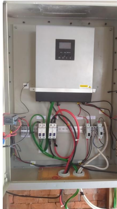
Gambar 2. Komponen PLTS yang sudah terpasang
