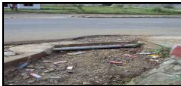
Gambar 4. Kondisi gorong – gorong yang tertimbun sedimen
