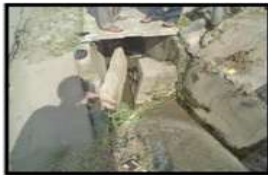
Gambar 2. Kondisi Saluran Drainase Yang Telah Rusak
