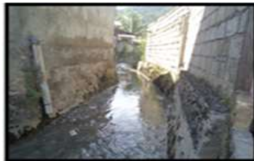
Gambar 5. Penyempitan Saluran Drainase
