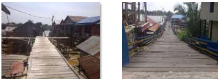
Gambar 2. Kondisi Jalan di Wilayah Studi
