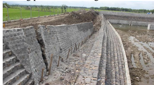
Gambar 6 Kondisi dinding penahan eksisting di lapangan.
