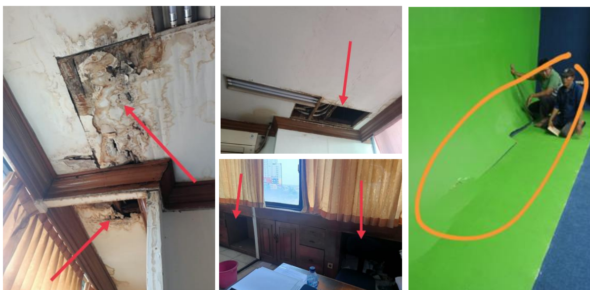
Gambar 1. Plafon dan Wardrobe Ruang Teknik Serta Greenscreen pada Lab Fikom yang Rusak Sebelum Dilakukan Renovasi
