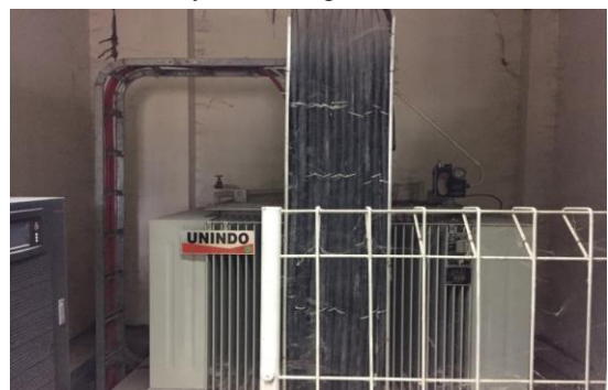
Gambar 3. Bentuk Fisik Transformator Step – Down
