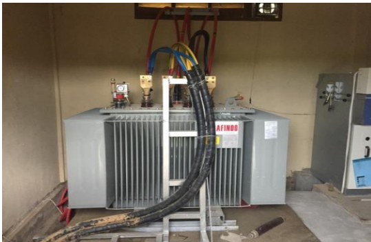
Gambar 4. Bentuk Fisik Transformator Step – Up
