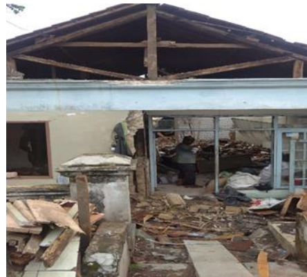
Gambar 3. Rumah Tinggal yang rusak
