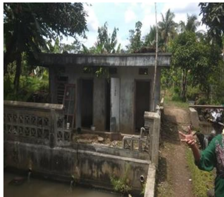
Gambar 2. MCK yang rusak
