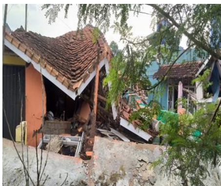
Gambar 4. Rumah Tinggal yang rusak
