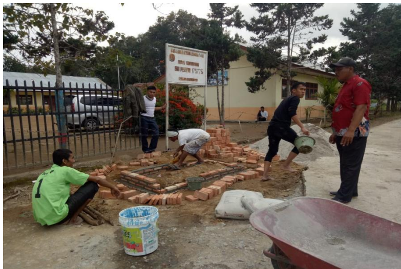
Gambar 1 . bak penampungan sampah lokasi SD Negeri Pearung
