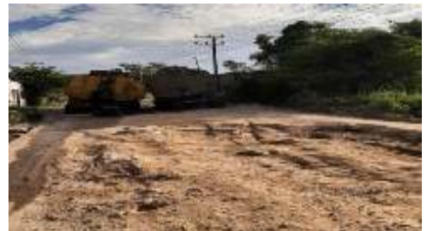
Gambar 1.1 Kerusakan jalan dan muatan kendaraan yang melebihi kapasitas jalan
