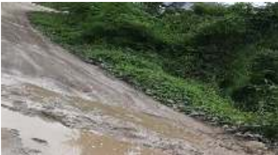
Gambar 1.3 Kerusakan jalan dan tidak terdapatnya bahu jalan serta saluran drainase
