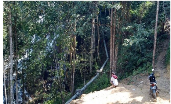
Gambar 3 Pipa intake air minum yang dibangun oleh Dirjen SDA PUPR
