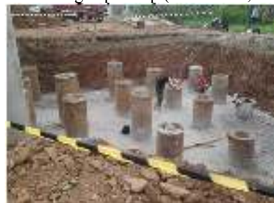
Gambar 1. Pondasi tiang pancang jenis spun pile yang digunakan pada proyek Jalan Tol Becakayu
