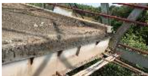
Gbr. 2 Stiffner tidak ada
